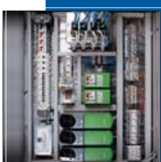
Cuadro eléctrico Electrical panel Panneau électrique
