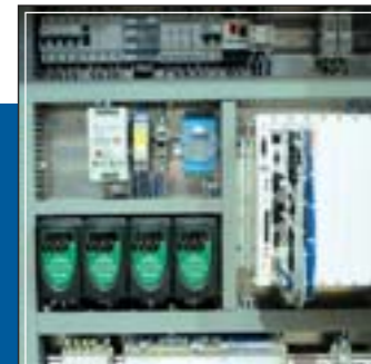
Cuadro eléctrico con PC industrial Electrical panel with industrial PC Panneau électrique avec PC industriel
